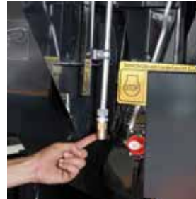
Un compressore d'aria trova posto dietro il gruppo radiatori. L'impianto è dotato di 3 uscite, una per lato della mietitrebbia ed una sul vano motore
